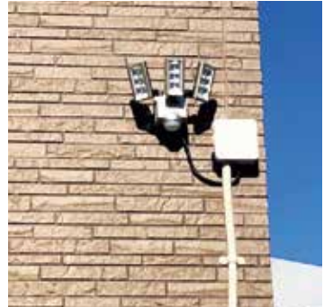
④駐車場照明
