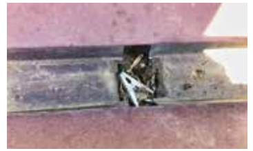
④雨どいのつまり状況
